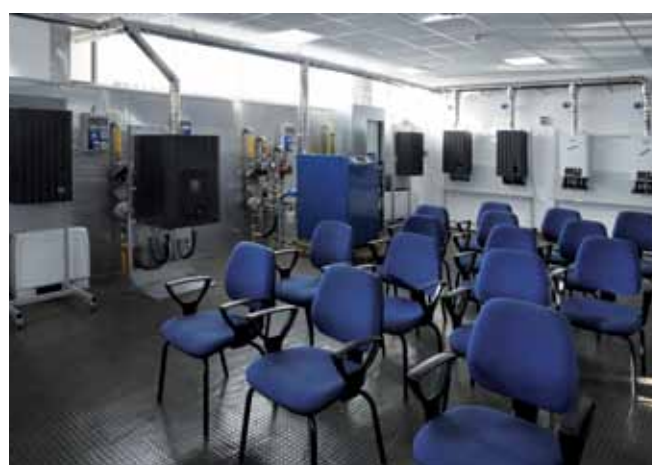
La sala prove con impianti funzionanti dove si tengono i corsi di formazione
